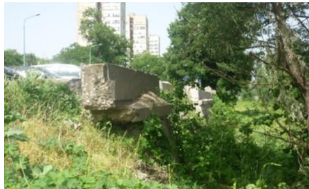
Фигура 19: Разрушения по подпорната стена и бетоновия парапет
