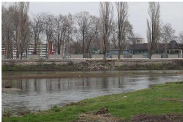
Фигура 18: Разрушена подпорна стена в района на Панаирното градче
