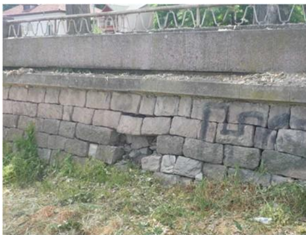
Фигура 20: Разрушения по подпорната стена
